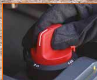
Přepínač odpojení baterie
