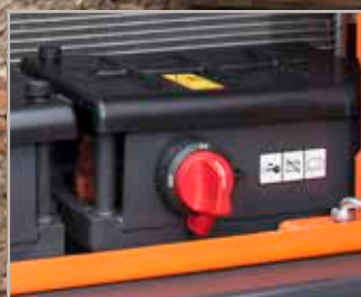
Přepínač odpojení baterie
